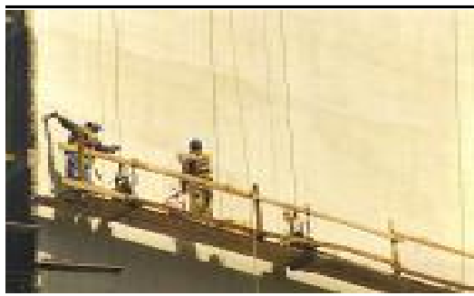
obra Terrazas de Campos. aplicación de ColorSEAL® PLUS Bianco Pietra en medianera.
